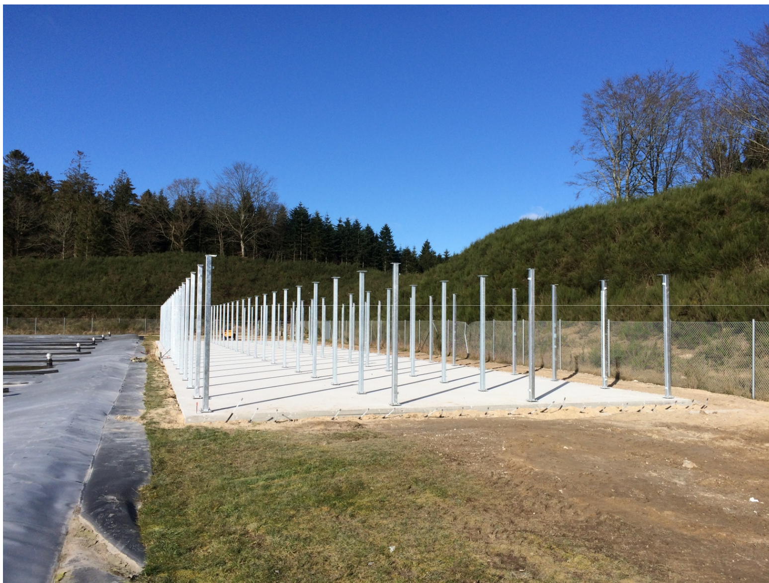
Nordside af damlager – med søjler til luftkølere
