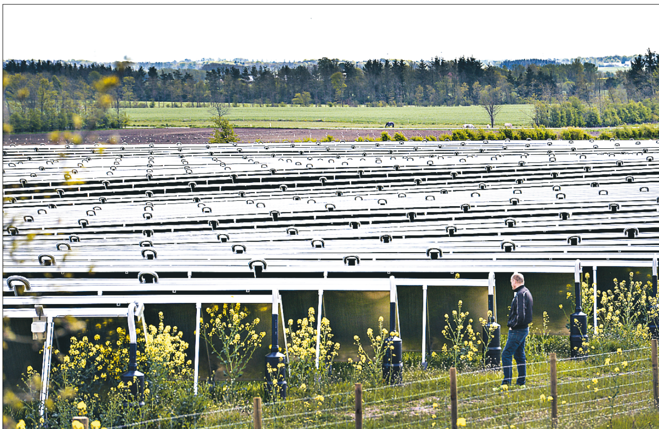
2982 solvarmeplader fylder 37.573 kvadratmeter på en mark nær Dronninglund. Der er 21 solfangere i hver række, og anlægget er ved indvielsen det største i verden. I en nedlagt grusgrav på den anden side af vejen er opført et stort varmelager, der rummer 62.000 kubikmeter vand.
